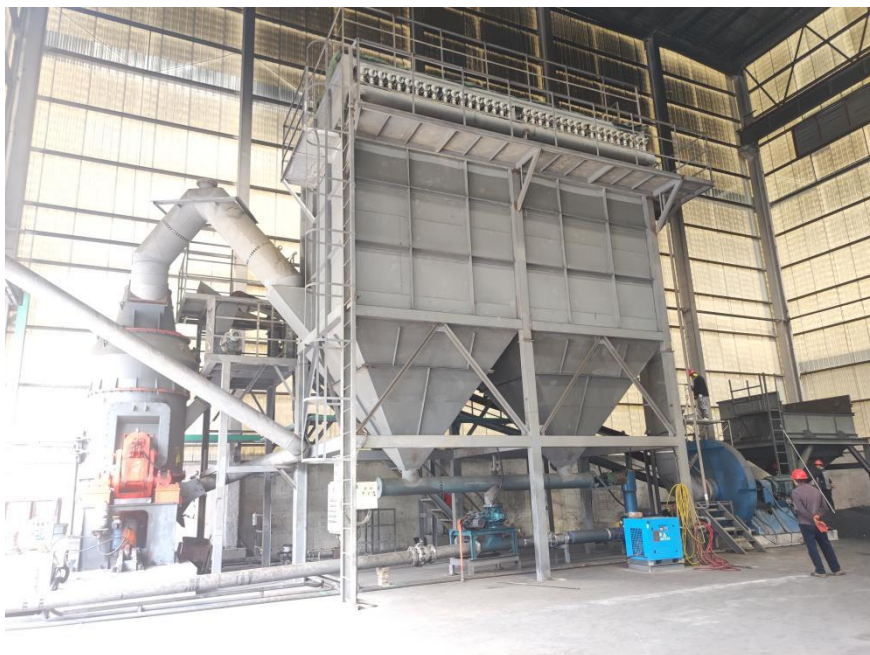
图 4.1-7 粉煤站及布袋除尘器现场图片
