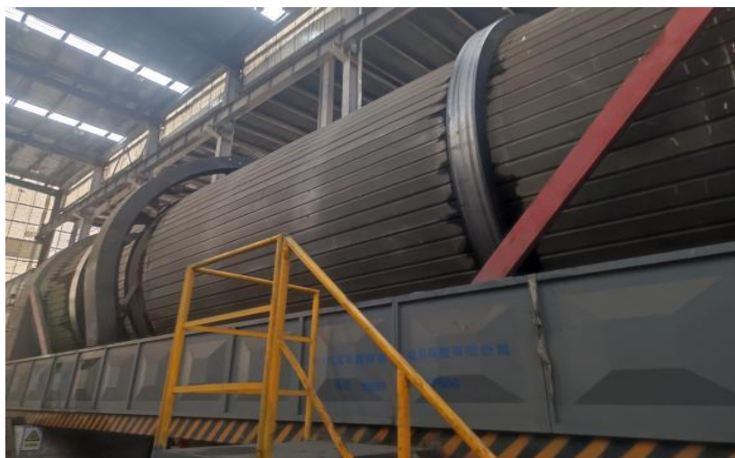
图 4.1-5 干燥窑现场图片
